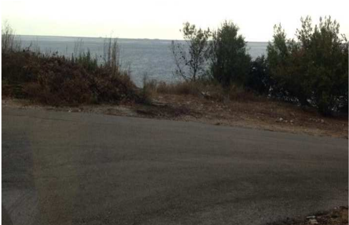
Slika 14. Istrošeni asfalt na dionici Čara-Smokvica
