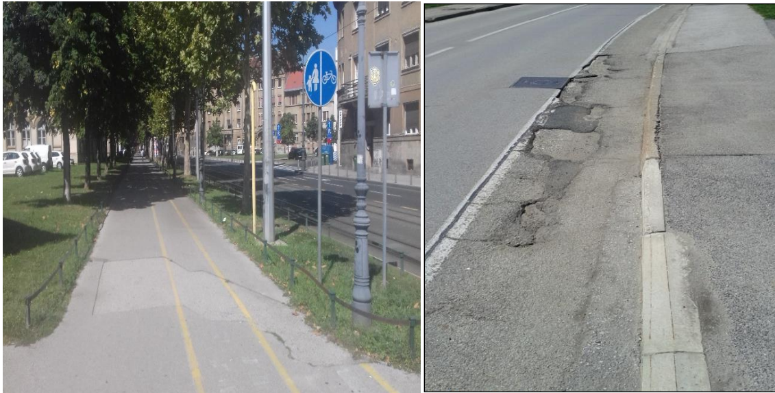
Slika 10. Nepravilna primjena prometnih elemenata i oštećenja [15]
