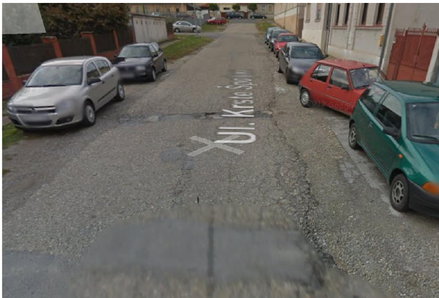
Slika 23. Oštećenje kolnika u Ulici Krste Špoljara u Bjelovaru[19]
