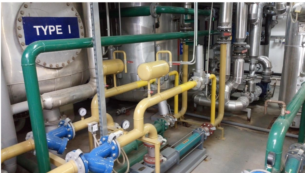
Slika 9. Postrojenje za prijenos tekućina za odleđivanje i zaštitu zrakoplova od zaleđivanja na MZLZ
