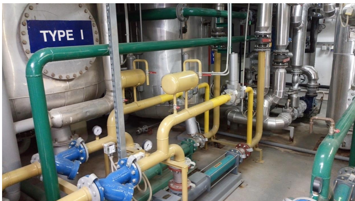
Slika 9. Postrojenje za prijenos tekućina za odleđivanje i zaštitu zrakoplova od zaleđivanja na MZLZ
