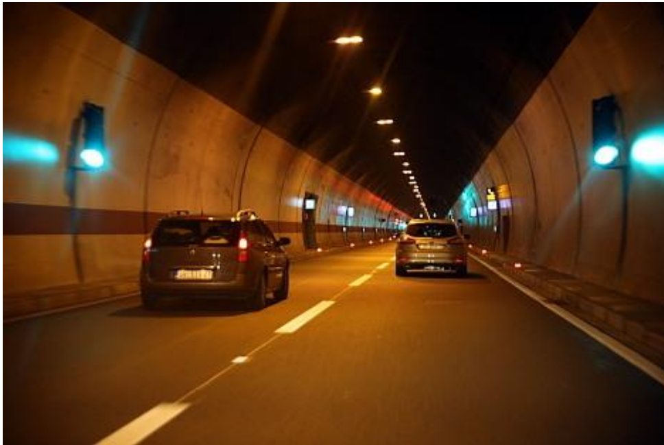
Slika 14. Centralni raspored rasvjete u tunelu
