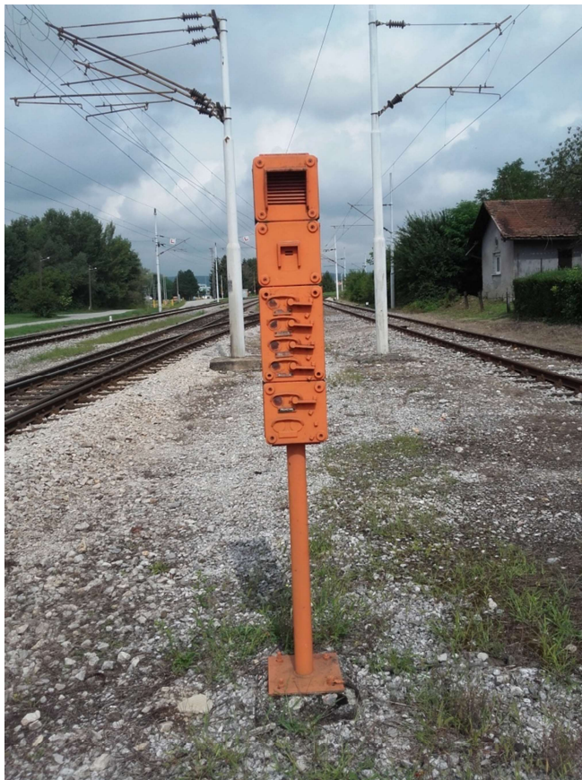
Slika 13. Interfon u kolodvoru Zaprešić
