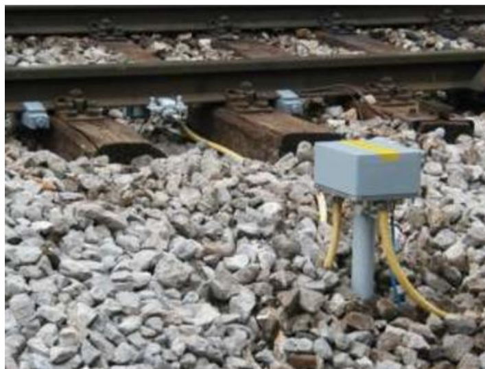
Slika 5. Kontrolni elektronički sklop VUR vanjskog uređaja u kutiji uz kolosijek [6].
