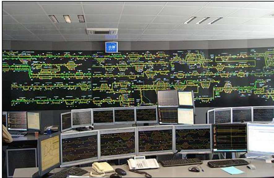
Slika 3: Moderna kontrola željezničkog prometa u Španjolskoj
