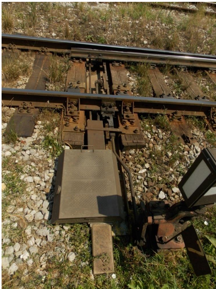
Slika 6. Skretnica pod rednim brojem 7 osigurana elektro – hidrauličnom postavnom spravom tipa L 650H
