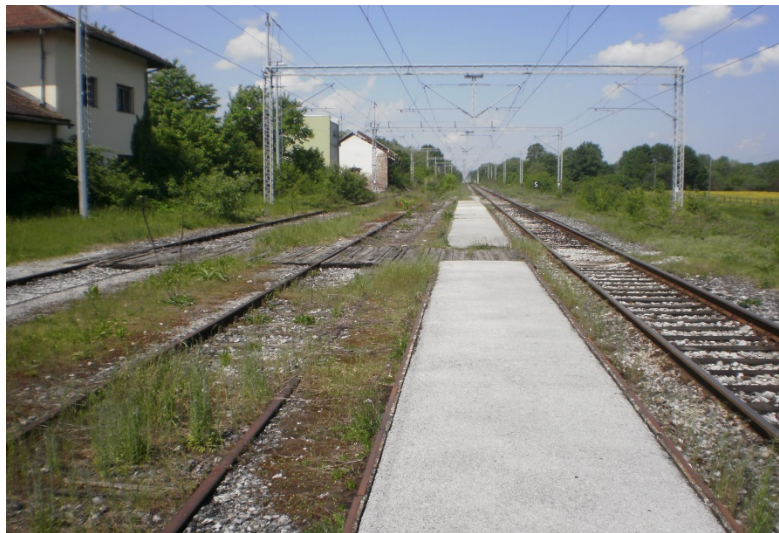
Slika 25: Trenutno stanje kolosijeka u nezaposjednutom kolodvoru Šaš
