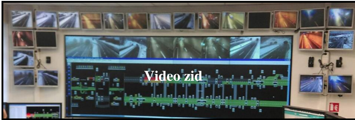
Slika 29. Monitori video sustava u COKP-i Delnice na autocesti A6, Autocesta Rijeka – Zagreb d.d., izvor [13]
