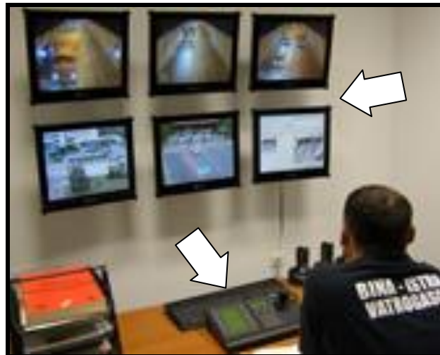
Slika 30. Monitori i upravljački modul video sustava tunela Učka, izvor [29]
