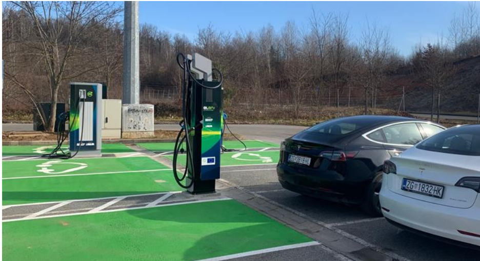
Slika 5. Stanica za punjenje električnih vozila
