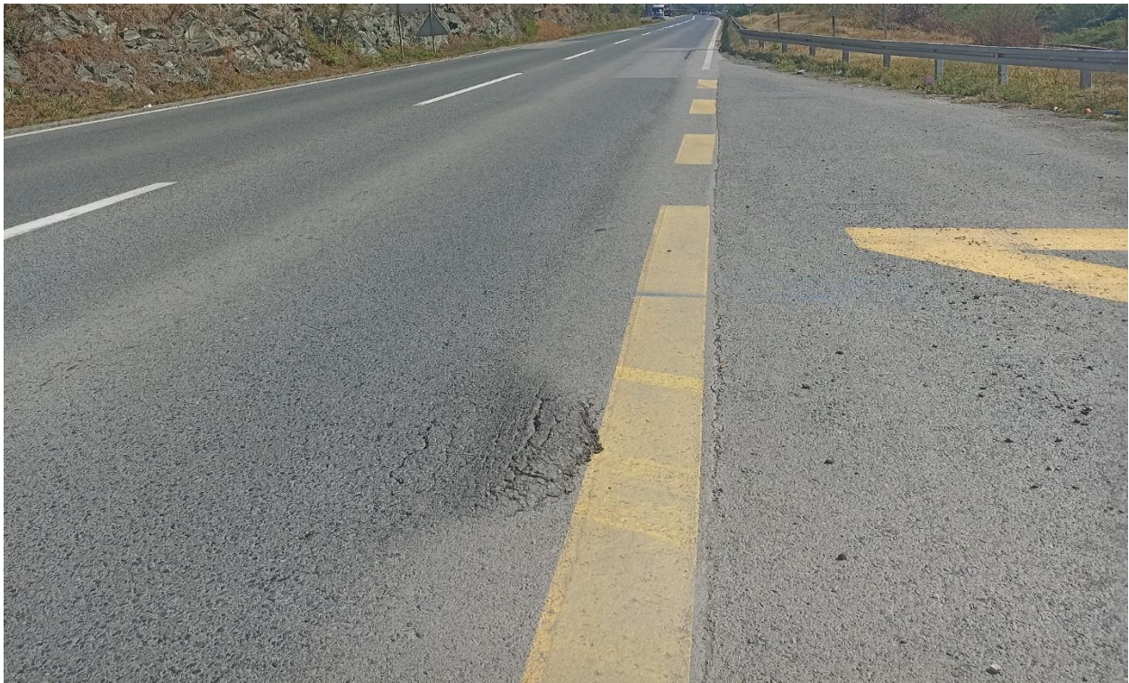
Slika 18. Oštećenje kolničke konstrukcije
