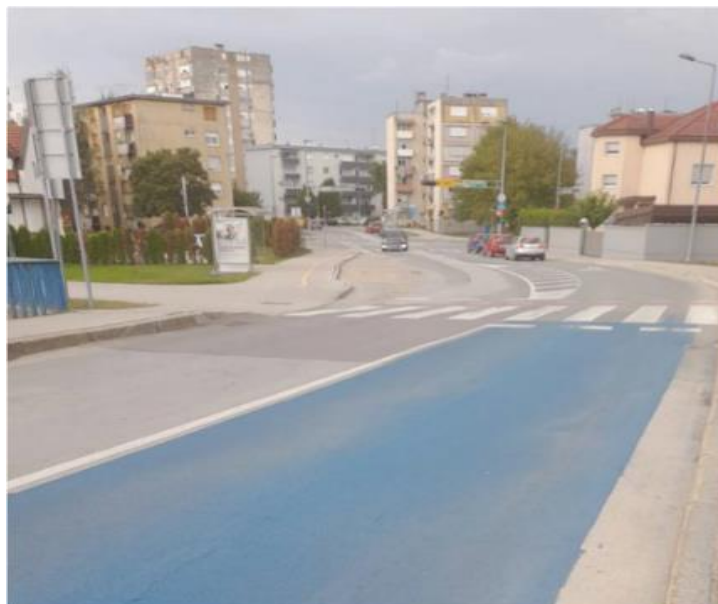
Slika 4. Prikaz implementacije specijalizirane protuklizne Tyregrip podloge na mostu u Ulici 13. srpnja u Karlovcu
