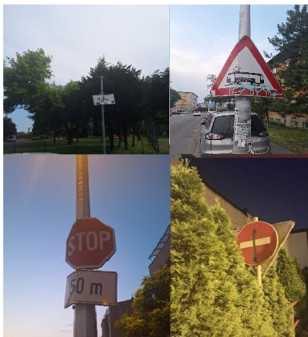
Slika 20. Oštećeni prometni znakovi
