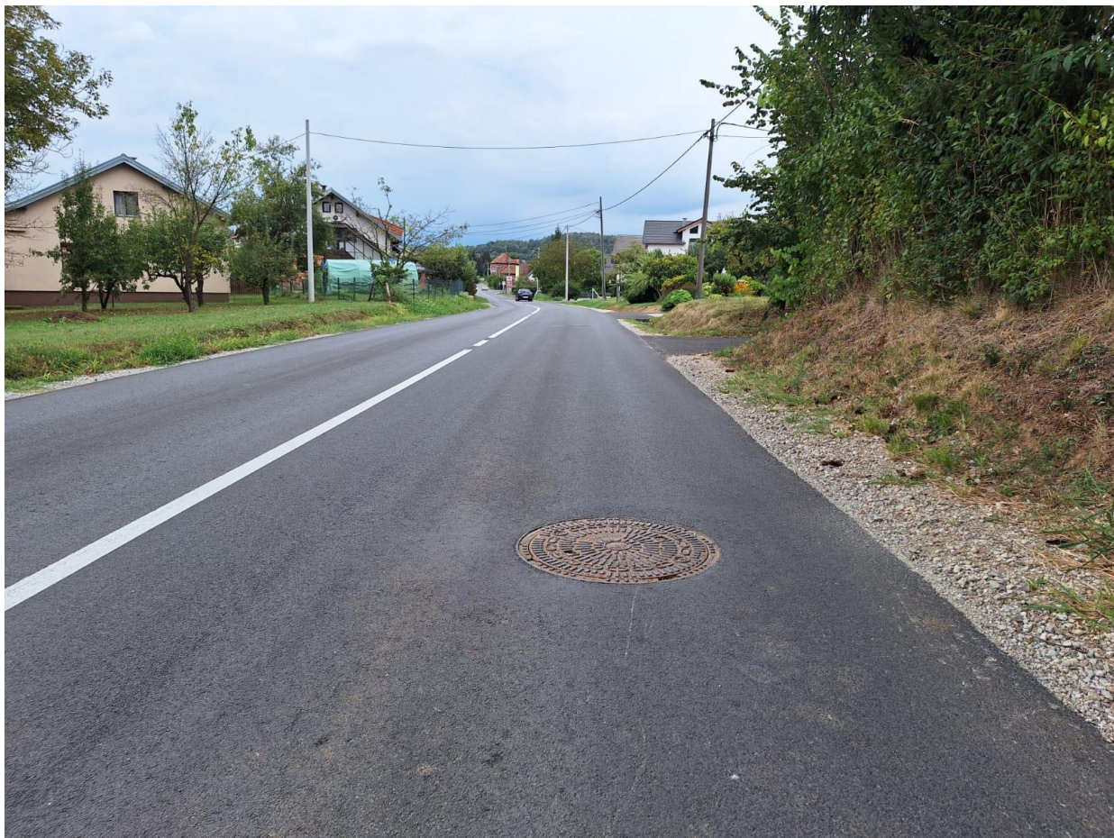
Slika 17 Primjer neadekvatno postavljenih šahtova na ŽC 3185
