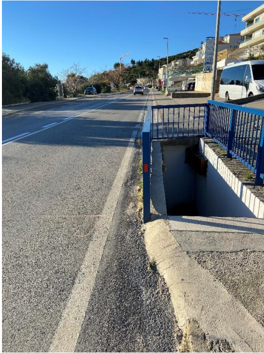
Slika e. neadekvatno označena ograda pješačkog pothodnika
