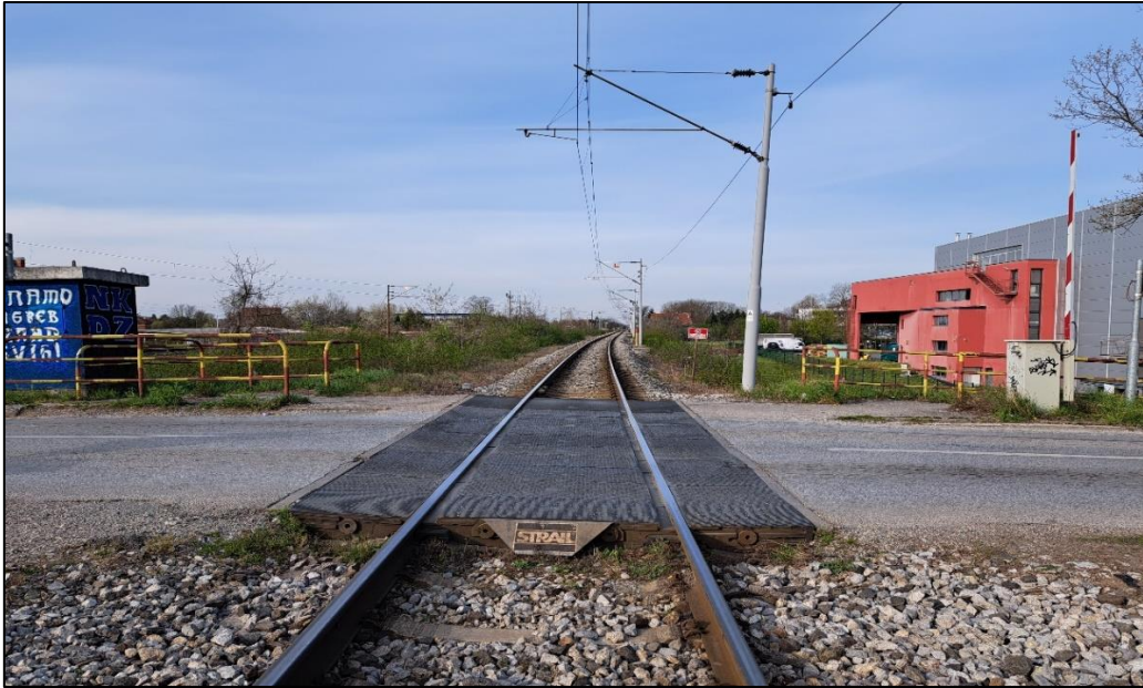
Slika 5. Željezničko-cestovni prijelaz 01 "Mega", smjer Zagreb GK - Hrvatski Leskovac
