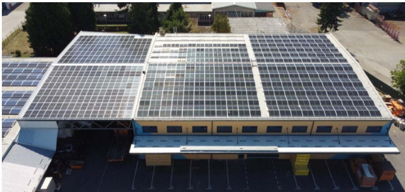
Slika 17. Prikaz solarnih panela, [39]
