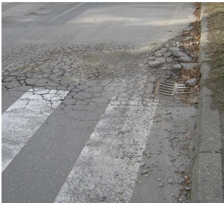
Slika 8: Oštećeni kolnik u ulici Ferdinanda Konščaka
