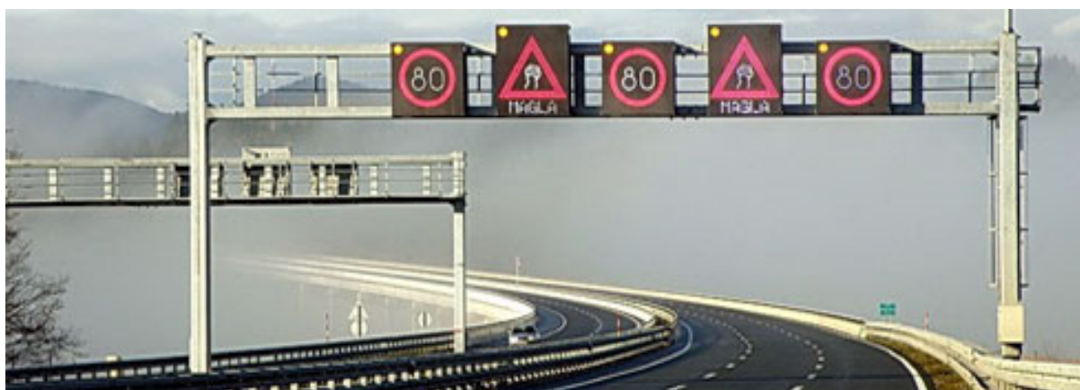
Slika 9. Primjeri promjenjivih prometnih znakova na autocesti
