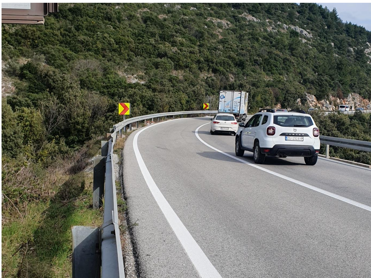
Slika 17. Oštećen plašt čelične zaštitne ograde
