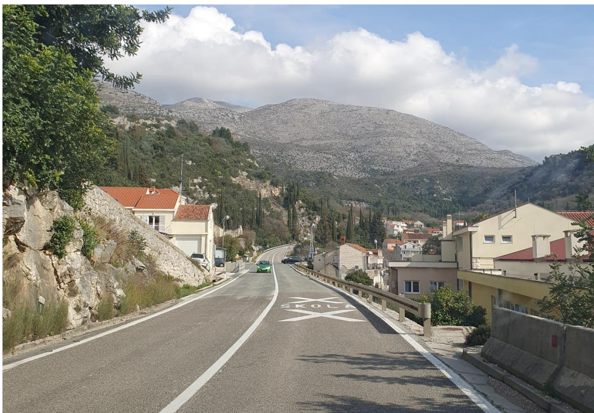
Slika 13. Nezaštićen prostor između čelične zaštitne ograde i betonske ograde „New Jersey“
