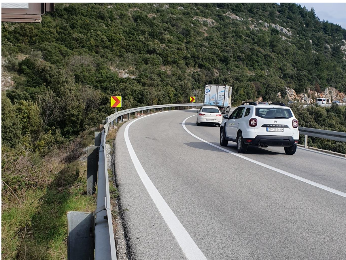
Slika 17. Oštećen plašt čelične zaštitne ograde
