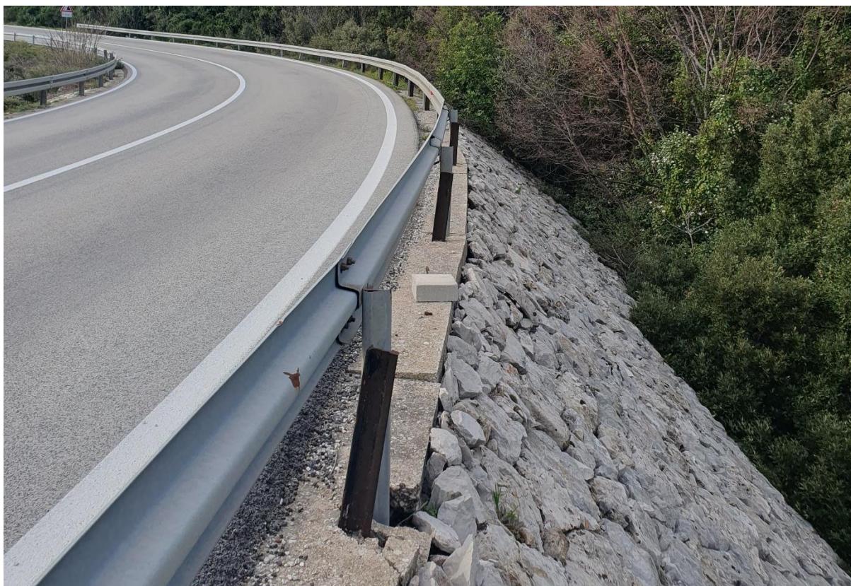
Slika 18. Neuklonjeni nezaštićeni stari stupovi zaštitne ograde
