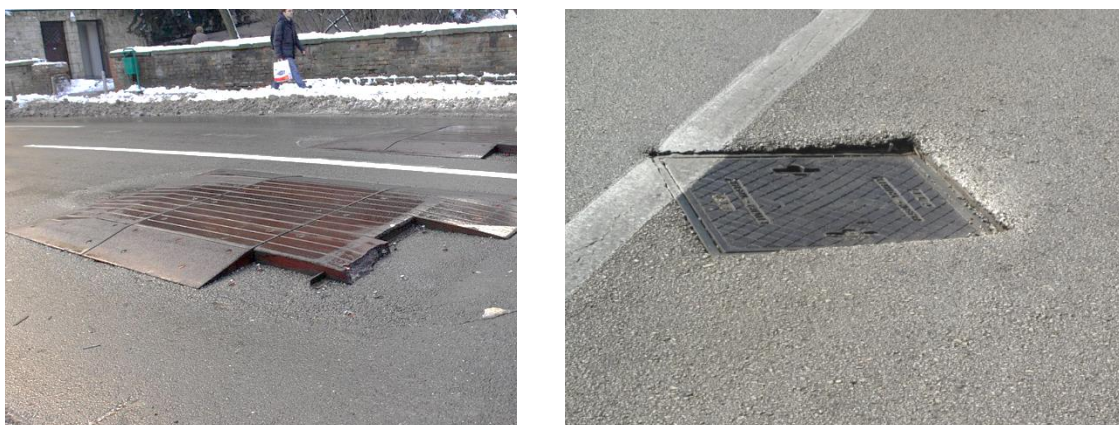
Slika 8. Primjer cestovnih elemenata koji predstavljaju rizik za vozače motocikala: a) uspornik, b) poklopac instalacijskog otvora
