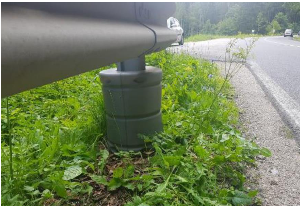
Slika 24. Ublaživač udara postavljen na metalni stup zaštitne odbojne ograde
