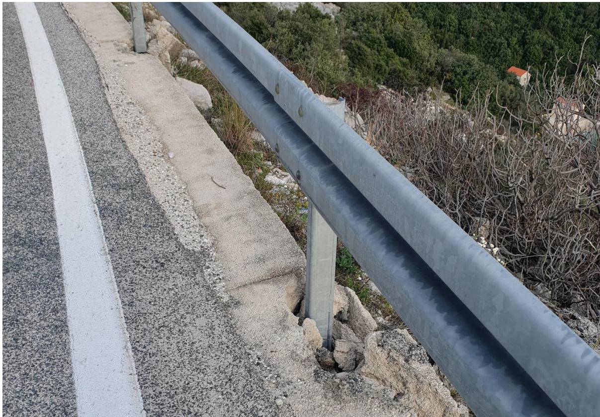
Slika 15. Otkrhnuta betonska podloga (pasica) uz stupove zaštitne ograde
