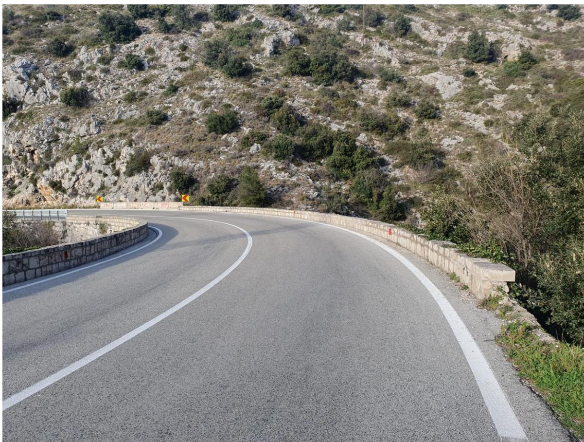
Slika 19. Neadekvatna niska betonska zaštitna ograda s nezaštićenim početkom
