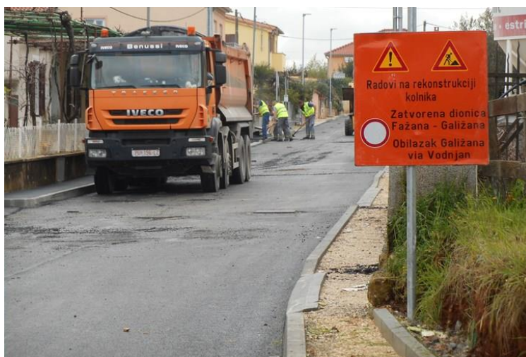
Slika 15: Prometna signalizacije za zatvaranje dionice ceste
