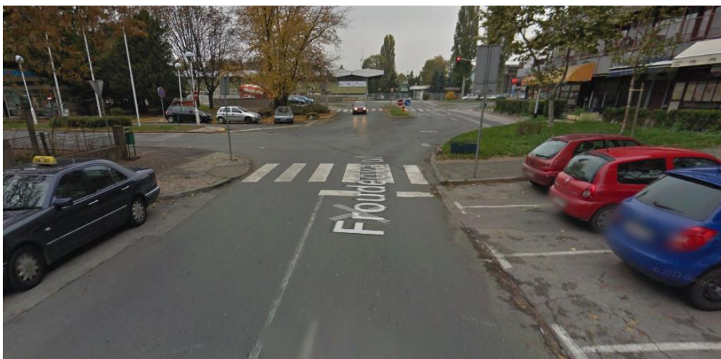
Slika 9. Pješački prijelaz nekvalitetno označen prometnom signalizacijom 12
