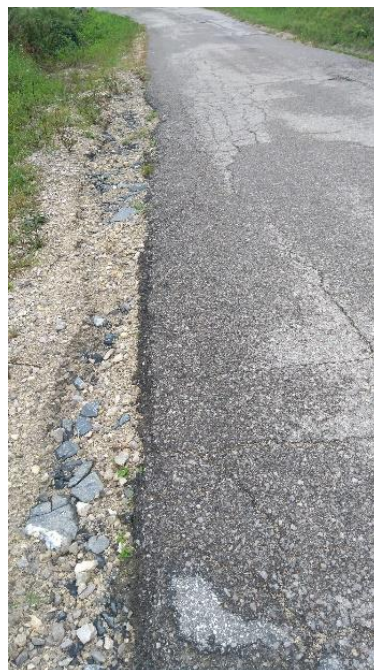
Slika 8. Prikaz oštećene bankine u mjestu Veliki Lipovec
