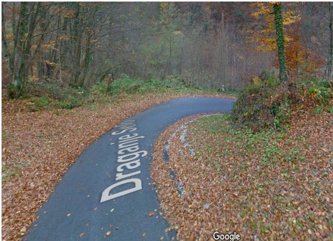
Slika 28. Prikaz oštrog zavoja prije sanacije
