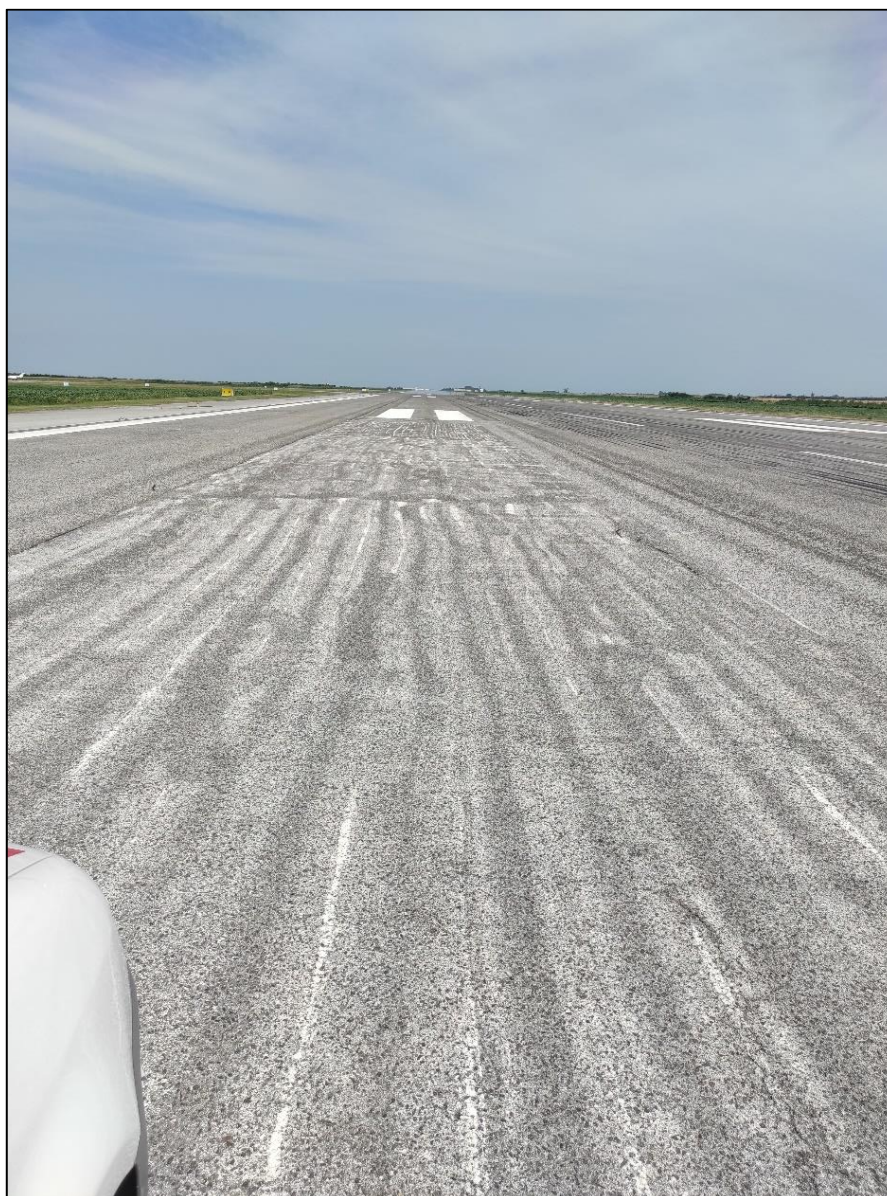
Slika 11. Prikaz oštećenja u zoni ciljne točke
