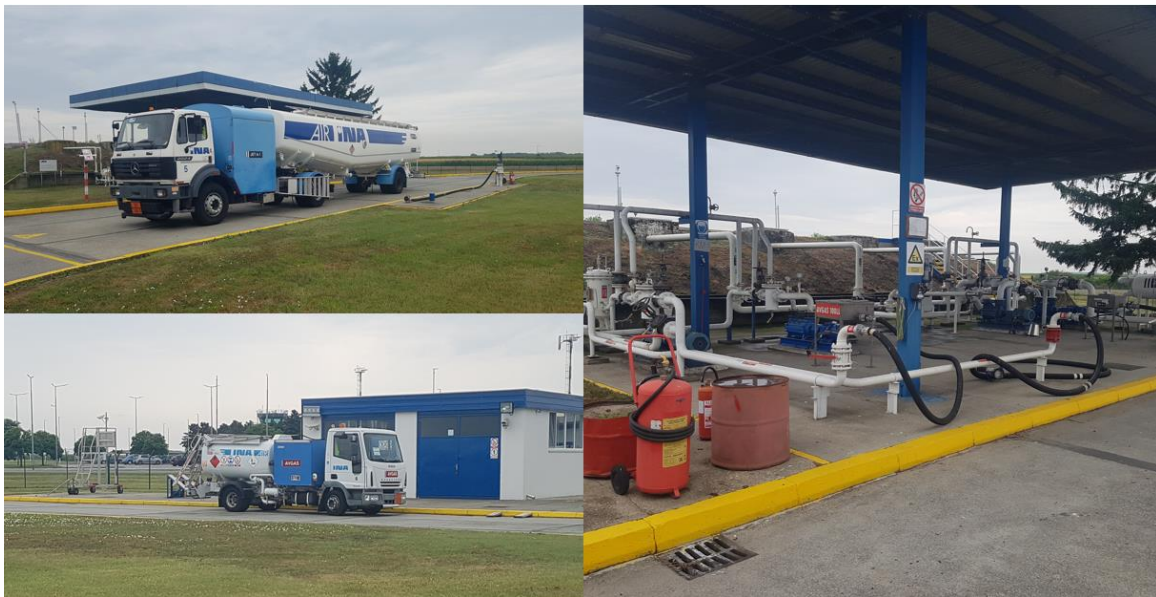
Slika 30. Infrastruktura INA avio servisa
