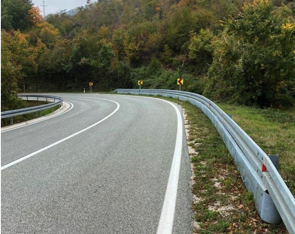
Slika 7. Zaštitna ograda s dodatnim elementom za motocikliste
