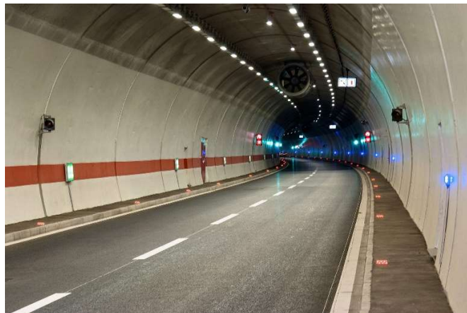
Slika 4. Kvalitetna rasvjeta u tunelu
