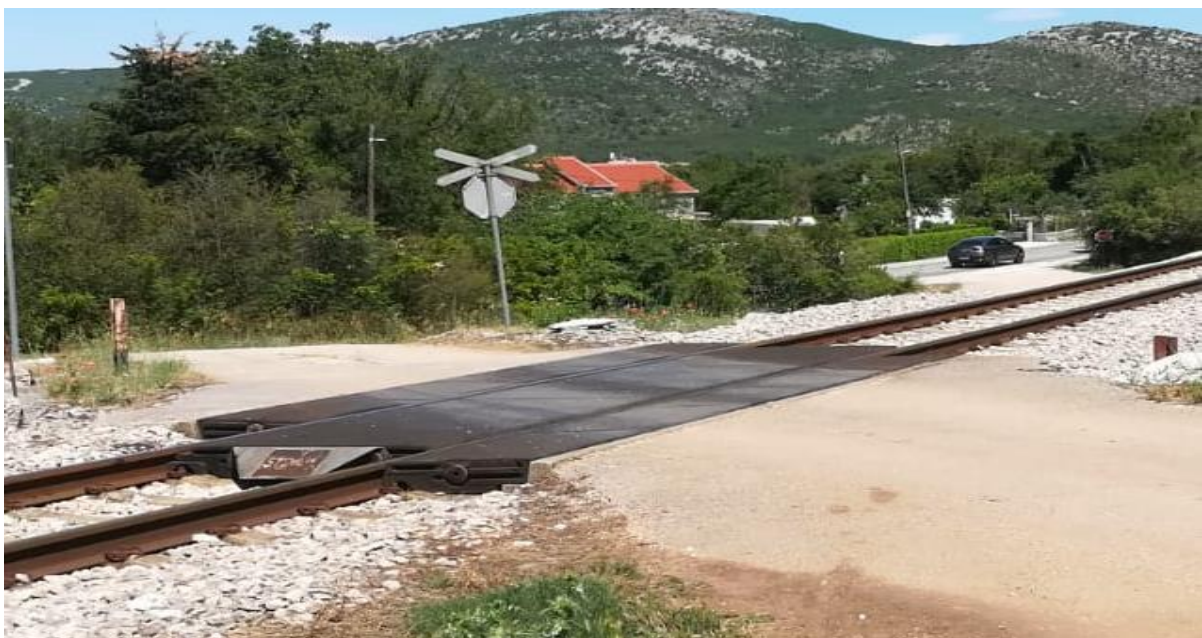
Slika 35. Prikaz stanja gumiranih ploča na željezničko-cestovnom prijelazu „Runjići“
