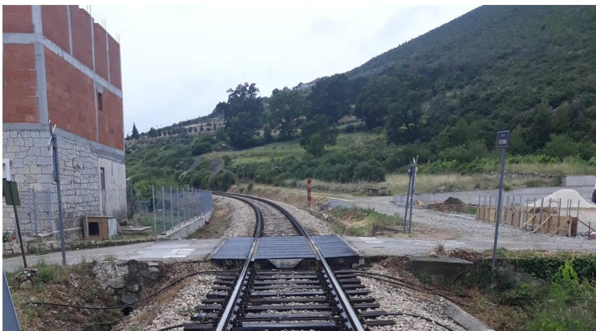
Slika 47. Prikaz stanja gumirane podloge na željezničko-cestovnom prijelazu „Trečanica“
