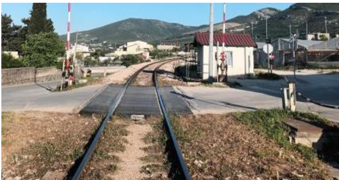
Slika 51. Prikaz stanja gumirane podloge na željezničko-cestovnom prijelazu „Kaštel Stari 1“
