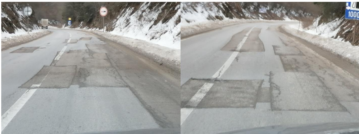
Slika 19. Oštećenja kolničke konstrukcije
