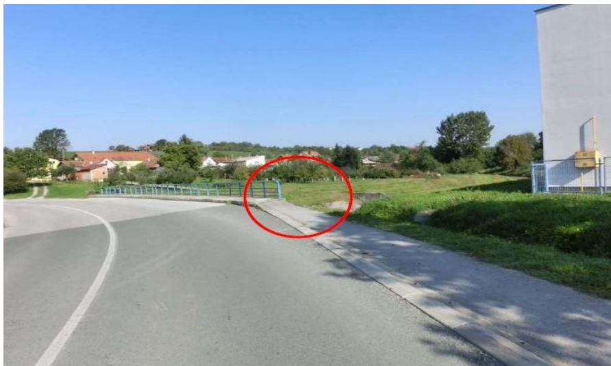
Slika 6. Neadekvatna zaštitna oprema ceste
