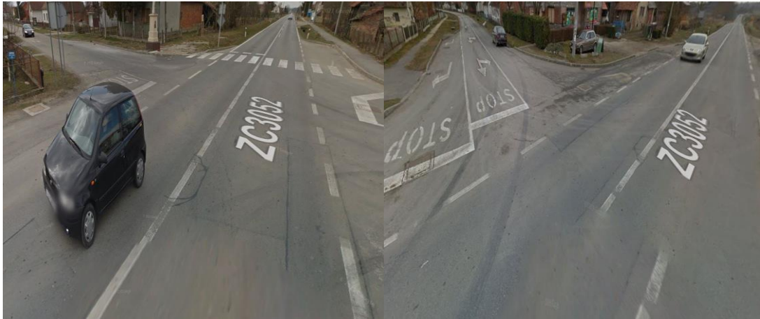
Slika 18. OM Severin – prije sanacije
