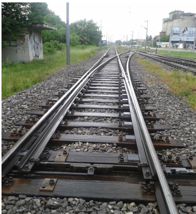
Slika 3. Skretnica na manipulativnom kolosijeku u kolodvoru Podsused Tvornica
