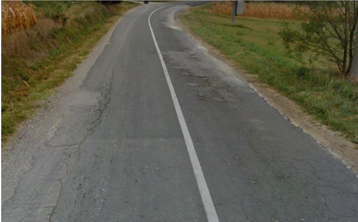
Slika 15. Dio kolnika na županijskoj cesti Ž2175
