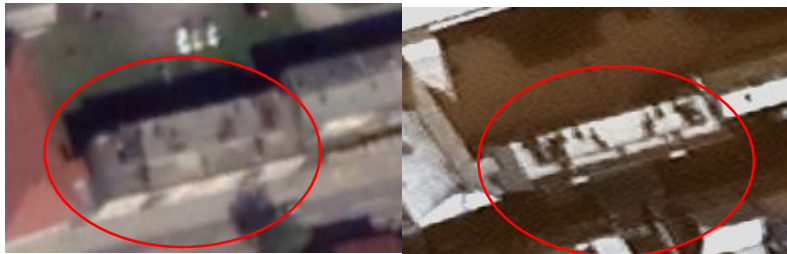
Slika 29. Objekt prikazan na snimkama prije i nakon potresa-1.primjer
