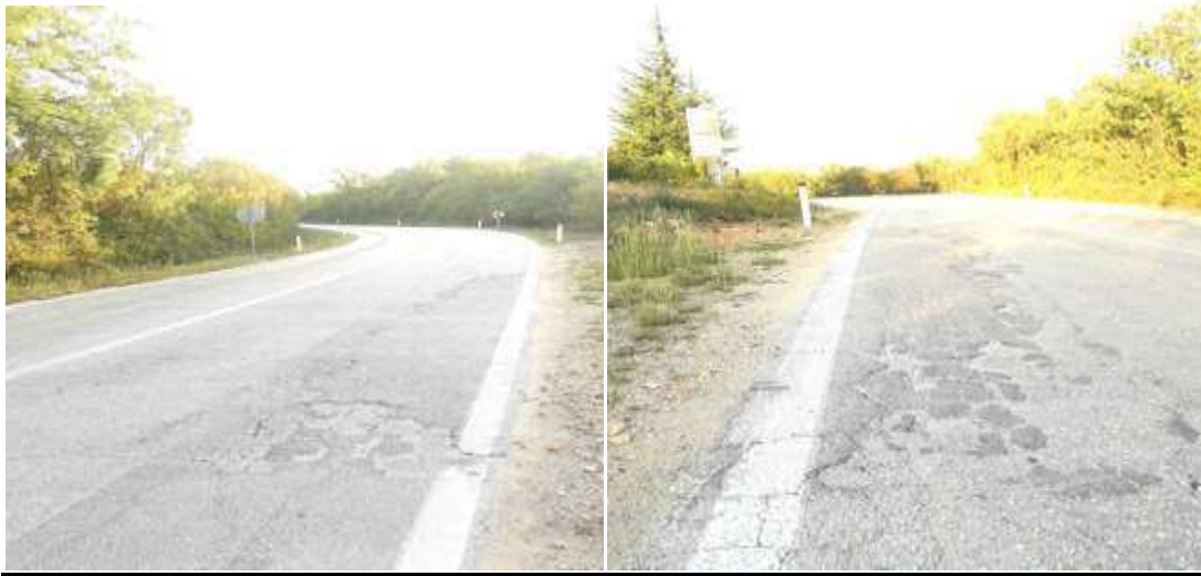
Slika 23. Oštećenje kolničke konstrukcije
