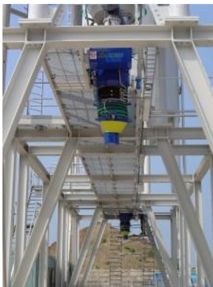
Slika 50. Teleskopski sustav ukrcanja biomase u kamion
