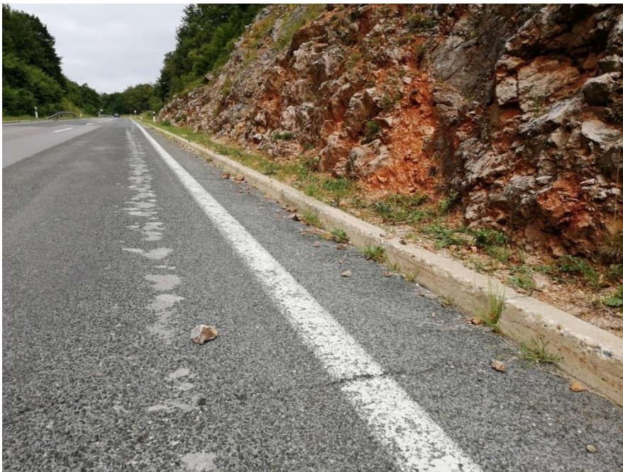
Slika 19. Odron kamenja na sjevernom prometnom traku
