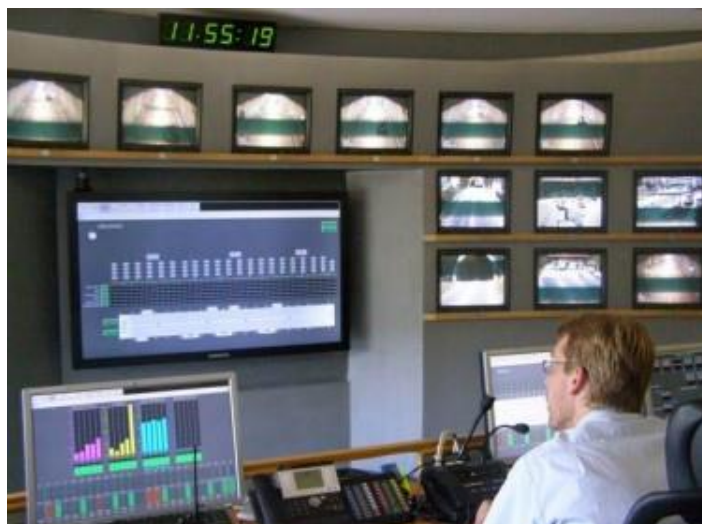
Slika 32. Sustav daljinskog upravljanja (SDU) tunela Učka, [3]
