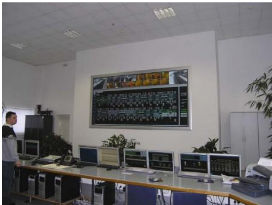
Slika 26. Centar za kontrolu prometa tunela Mala Kapela, [22]
