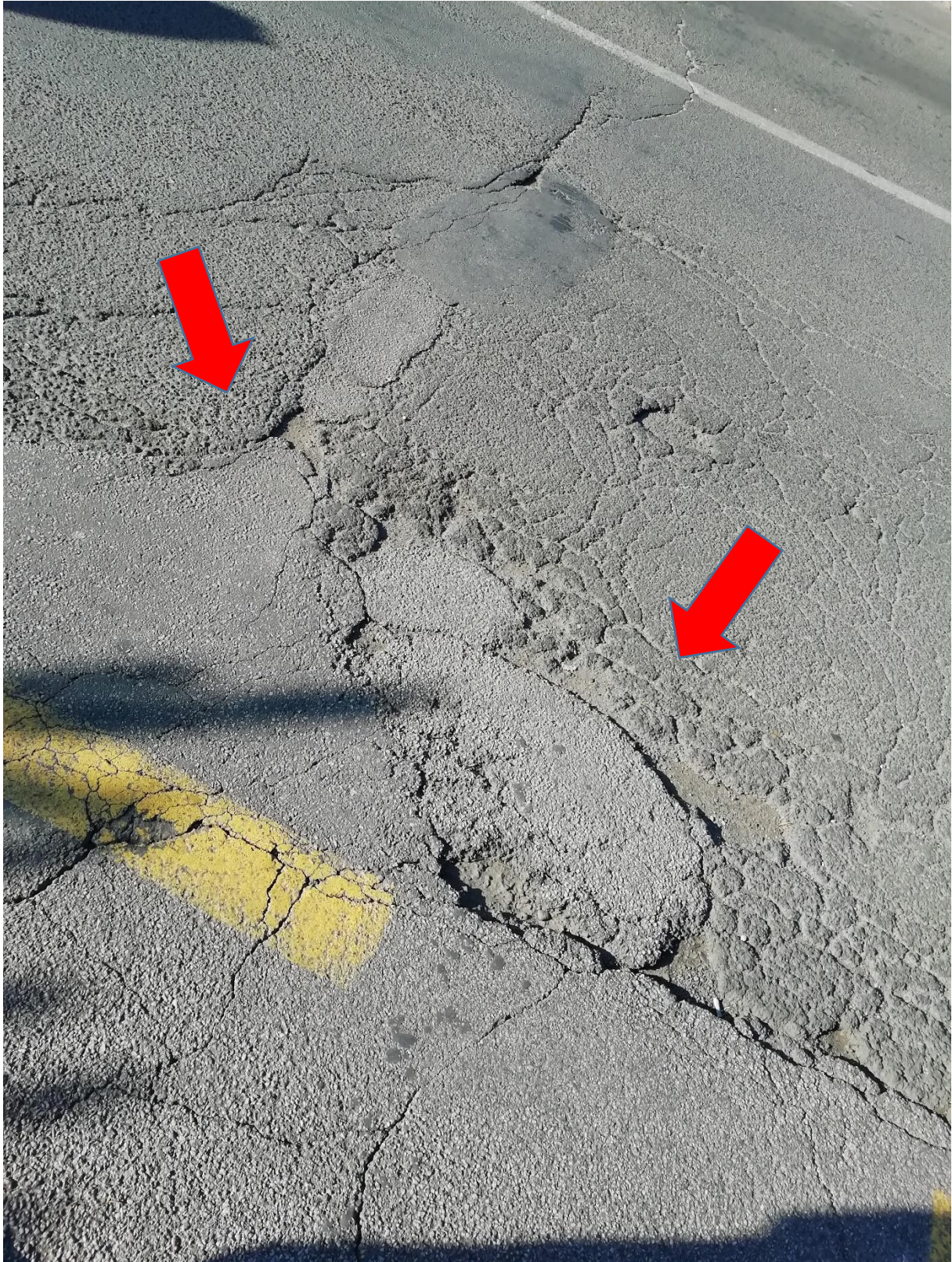
Slika 27. Prikaz oštećenja kolničke konstrukcije
