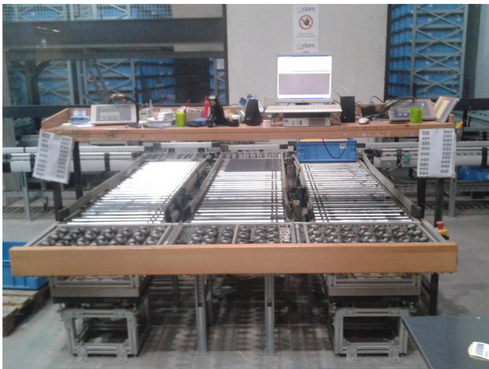
Slika 9. Upravljački pult robotiziranog skladišta
