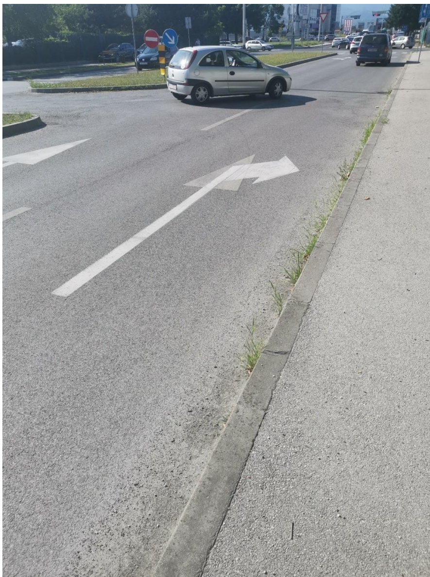
Slika 9. Neadekvatno uklonjena stara signalizacija na sjevernom privozu (2)
