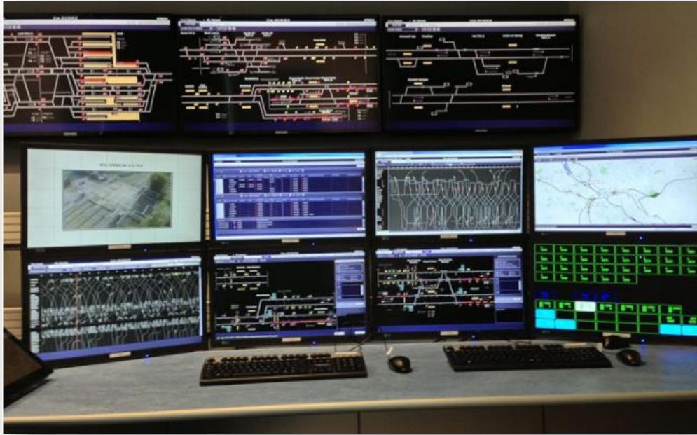
Slika 23. Izgled jedinice za upravljanje linija metro sustava
