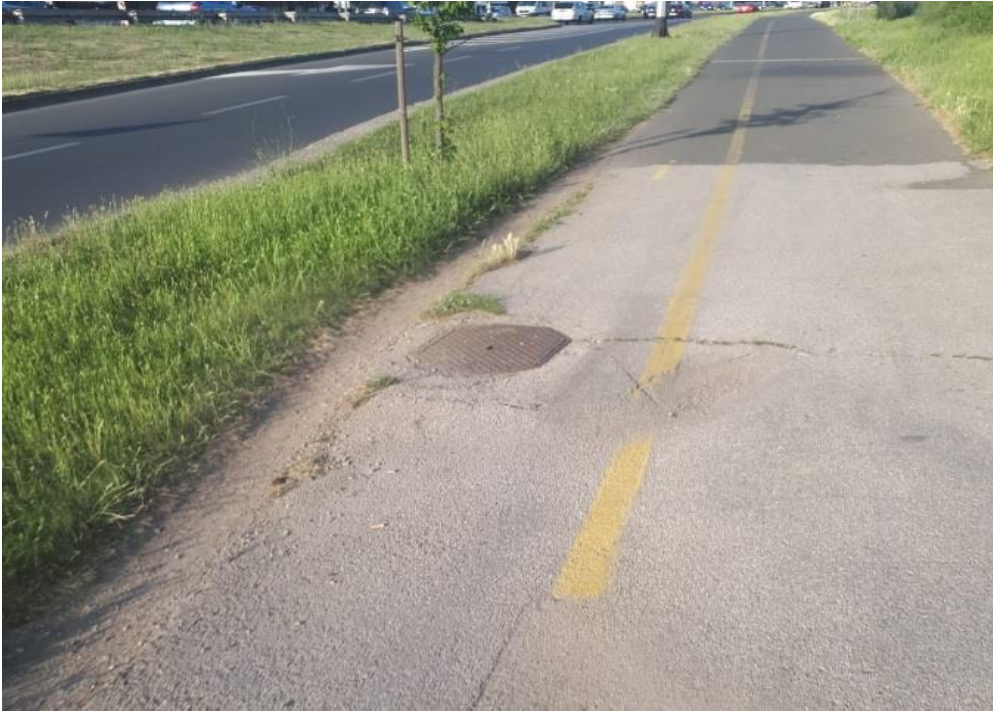
Slika 23. Primjer lošeg održavanja – Zagrebačka avenija [Autor]
