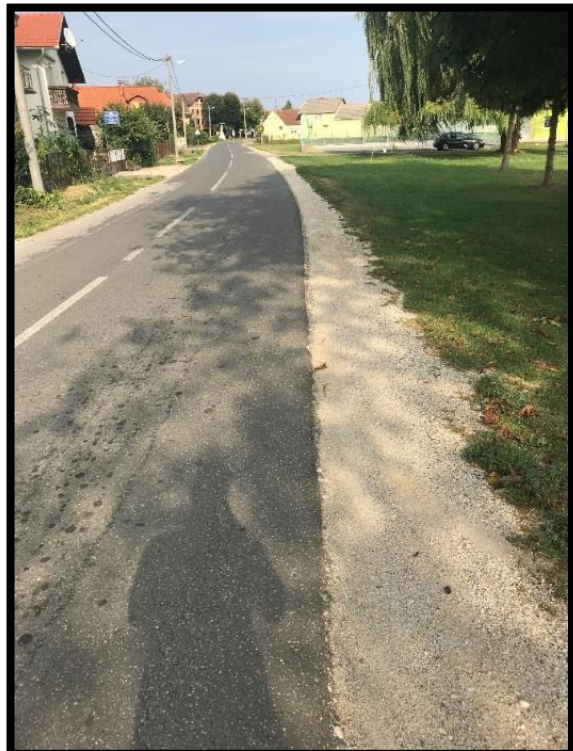
Slika 12. Oštećenje kolnika na istočnom privozu
