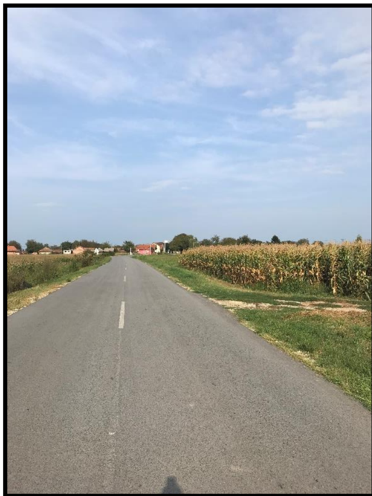
Slika 30. Stanje kolnika na lokaciji „4“
