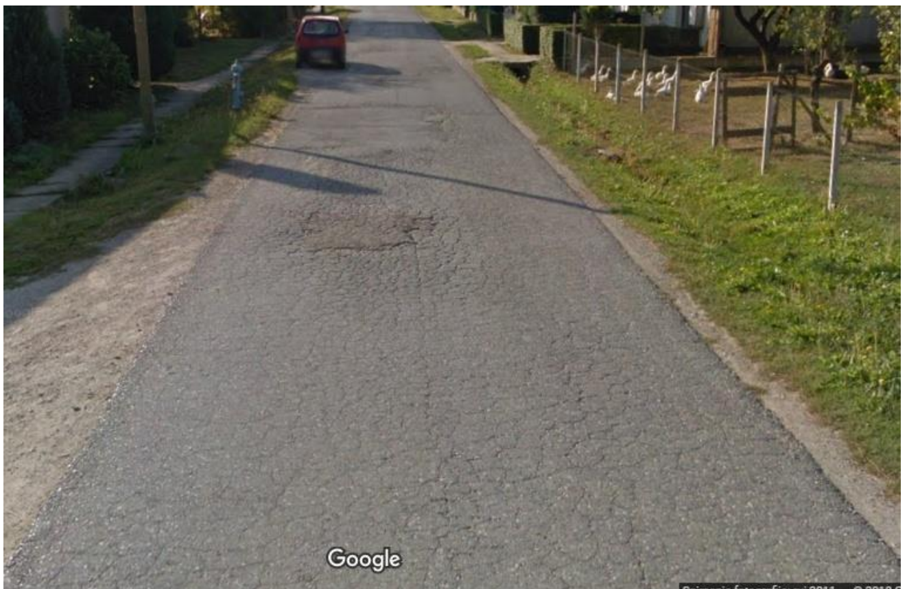
Slika 9. Dio kolnika lokalne ceste LC 26138 u naselju Karane
