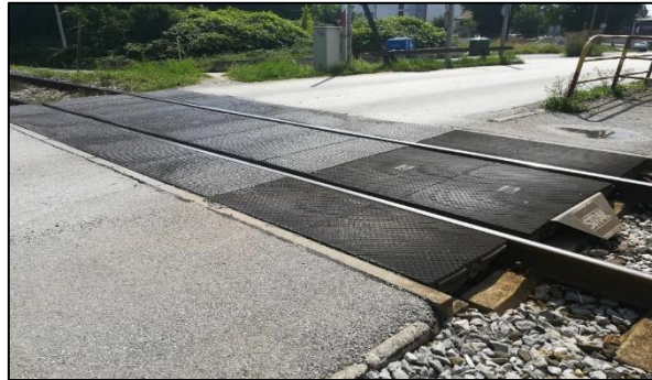
Slika 99. Prikaz stanja gumirane podloge na željezničko-cestovnom prijelazu „Savski Gaj“
