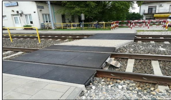
Slika 59. Prikaz stanja gumirane podloge na željezničko-cestovnom prijelazu „Stajalište Kraljevac“
