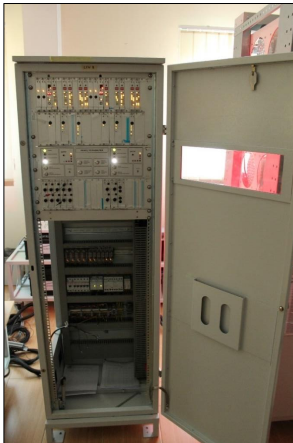
Slika 19. Upravljački ormar željezničko-cestovnog prijelaza
