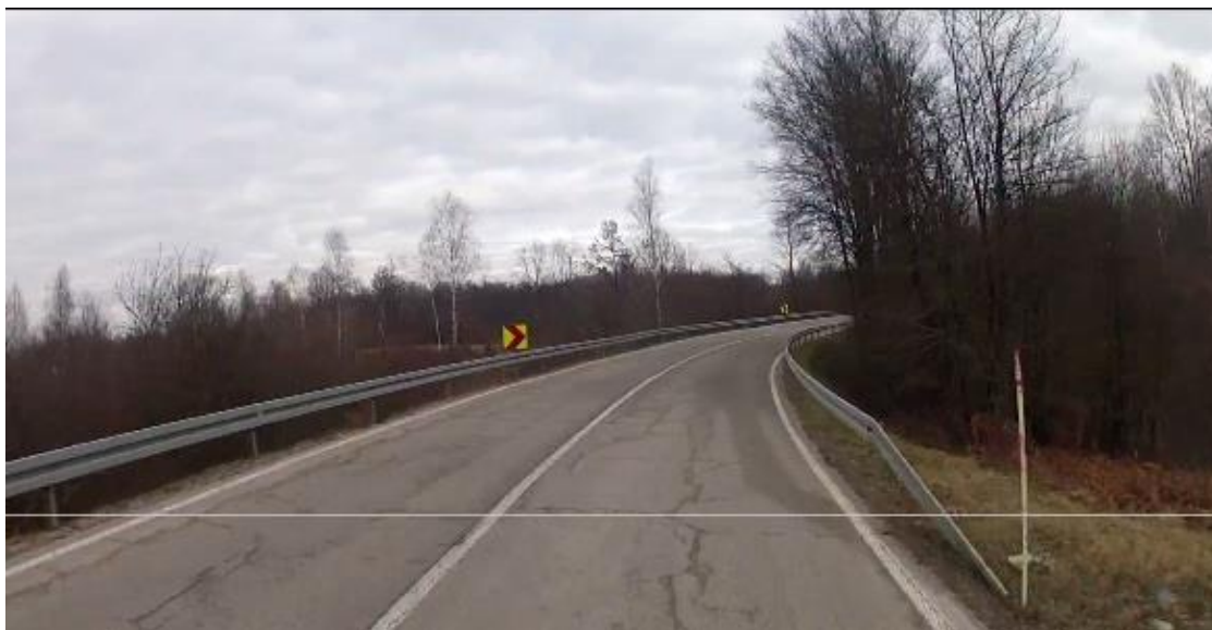
Slika 3. Prikaz neadekvatnog završnog elementa zaštitne odbojne ograde na cesti D3 [2]
