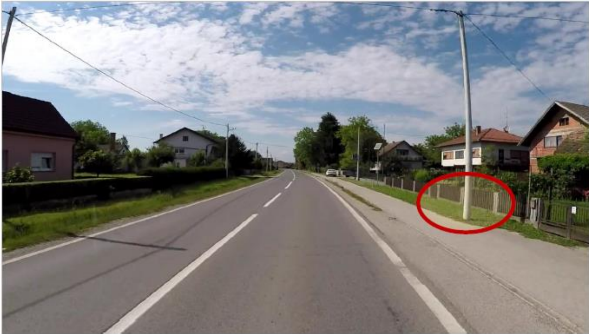
Slika 29. Prikaz nezaštićenog stupa javne rasvjete [5]
