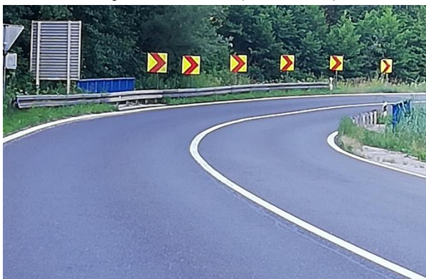
a) zaštitna ograda na objektu
