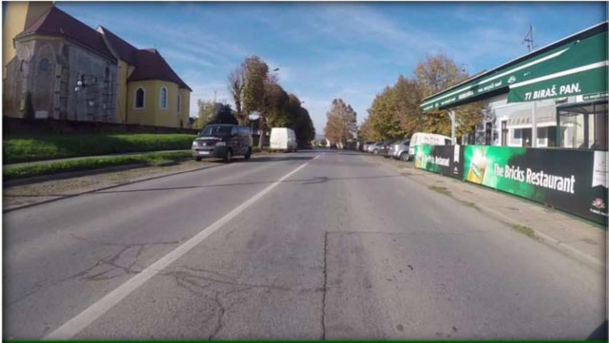
Slika 10. Prikaz pukotina na Trgu dr. Franje Tuđmana
